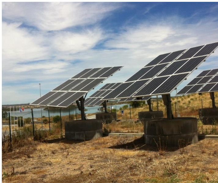
Figura 20 – Parque solar da EDIA em Alqueva
