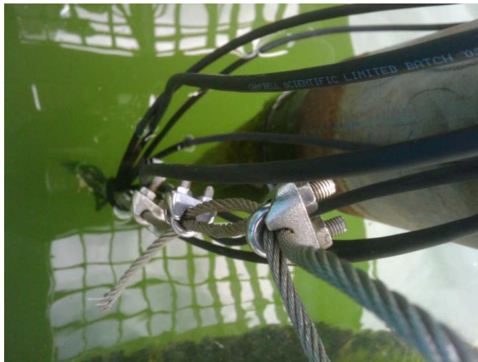
Figura 15 – Sondas de temperatura instaladas sob a plataforma
